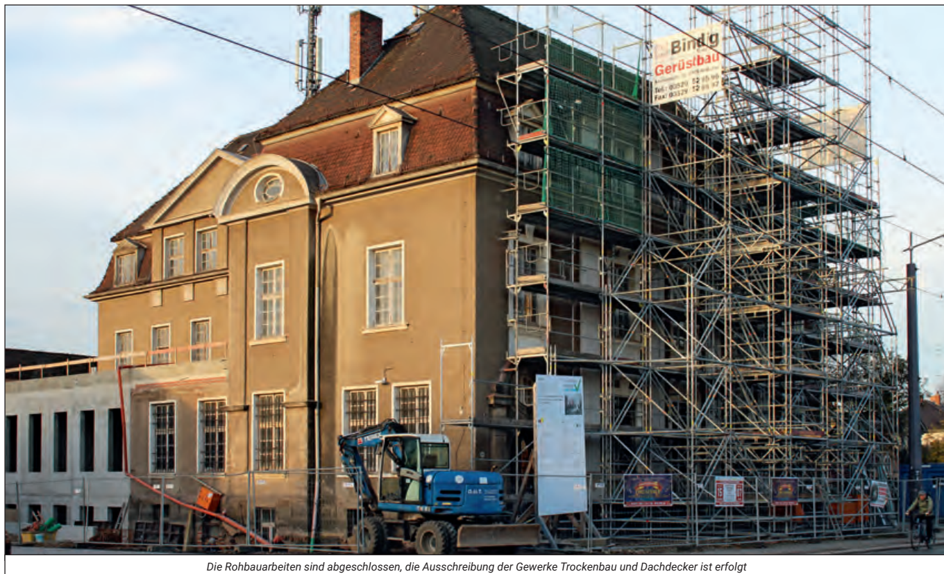
Die Rohbauarbeiten sind abgeschlossen, die Ausschreibung der Gewerke Trockenbau und Dachdecker ist erfolgt
